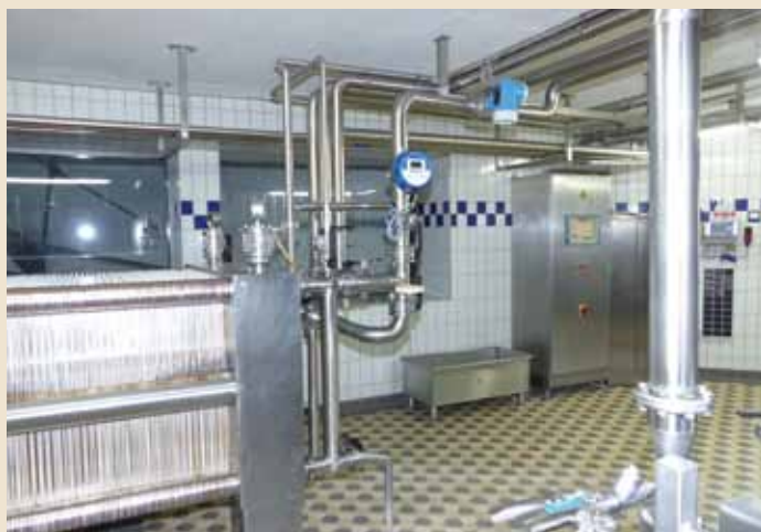
Eingesetzt wird das Inline-Messgerät nach der Filtration
